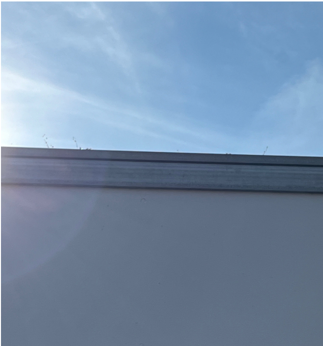
Abb. 14 Original Attika-Blech aktueller Zustand
